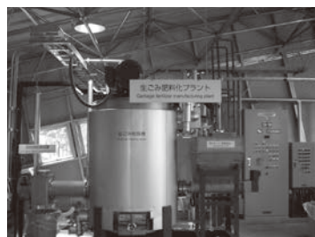
リサイクル研究センター (生ごみ肥料化プラント)
