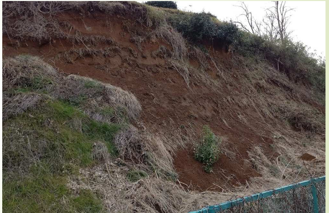
厚木キャンパスの崩壊斜面（BSC施工前）
