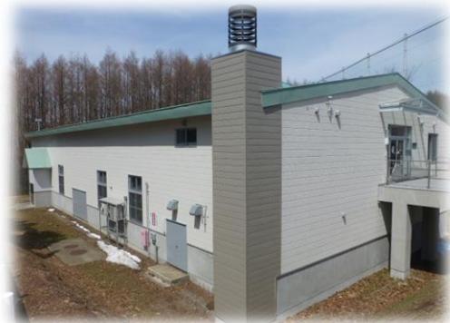
オホーツクキャンパス 9号館食品加工技術センター外壁改修
