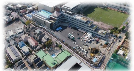
東京農業大学稲花小学校 校舎建設工事現場 (平成30年3月撮影)
