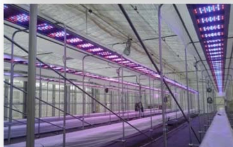
厚木キャンパス伊勢原農場 養液栽培設備 （教育研究活性化設備整備事業）
