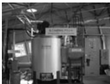
リサイクル研究センター (生ごみ肥料化プラント)
