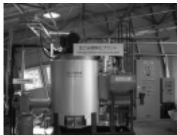
生ごみ肥料化プラント
