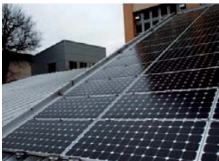
片流れの屋根に設置された太陽電池
