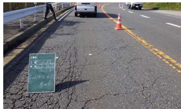
写真-2 開削地点 B(k.p.216.39)の路面状況
