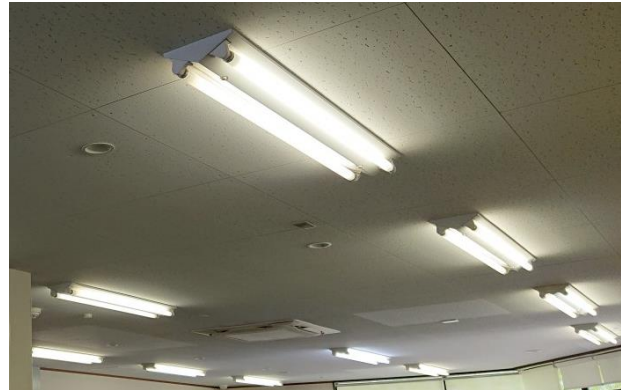
写真1 安定器・街路灯・蛍光灯
