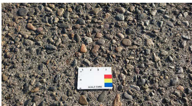
写真 2 長期供用された路面例
