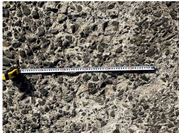
写真 8 施工前路面状況
