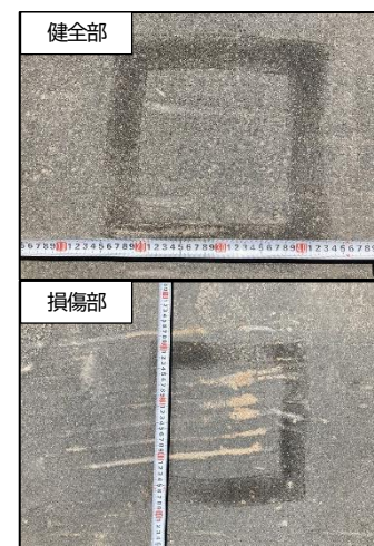
写真 13 施工後 2 年路面
